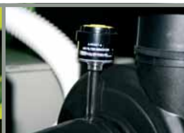
Индикатор загрязнённости воздушного фильтра
