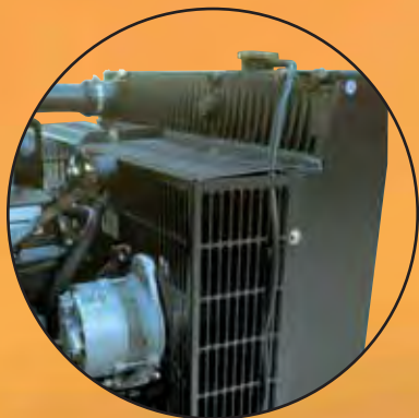
Защитная решетка на вращающиеся детали установки
