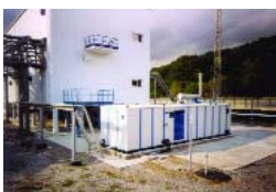
Контейнер NeuHaus с ДГУ мощностью 800 кВт
