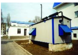
Контейнер NeuHaus с установленным ДГУ
