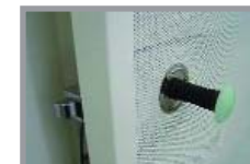
Система аварийного открытия дверей
